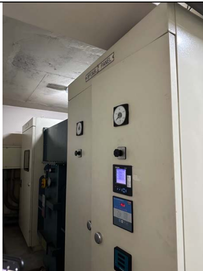
各棟總電表施工前
